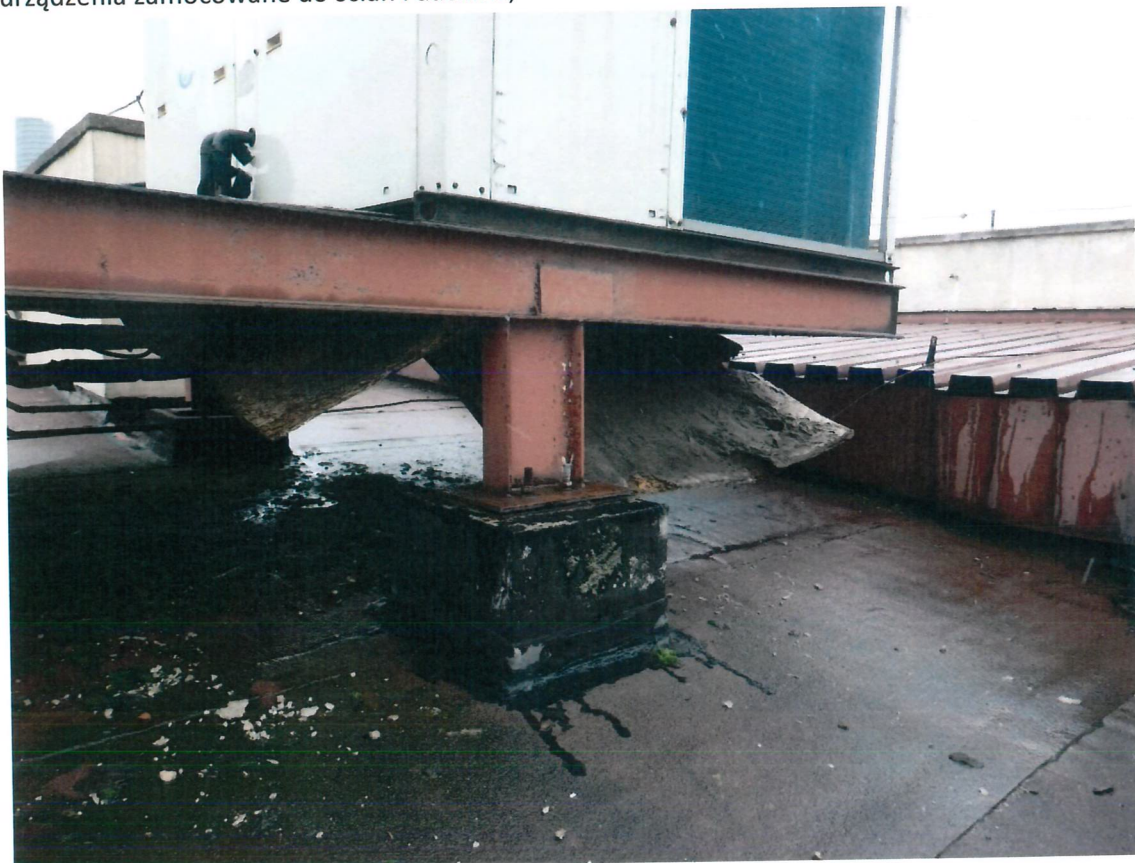
Fot.[8] Podkonstrukcje pod urządzenia na dachu – stan średni.
