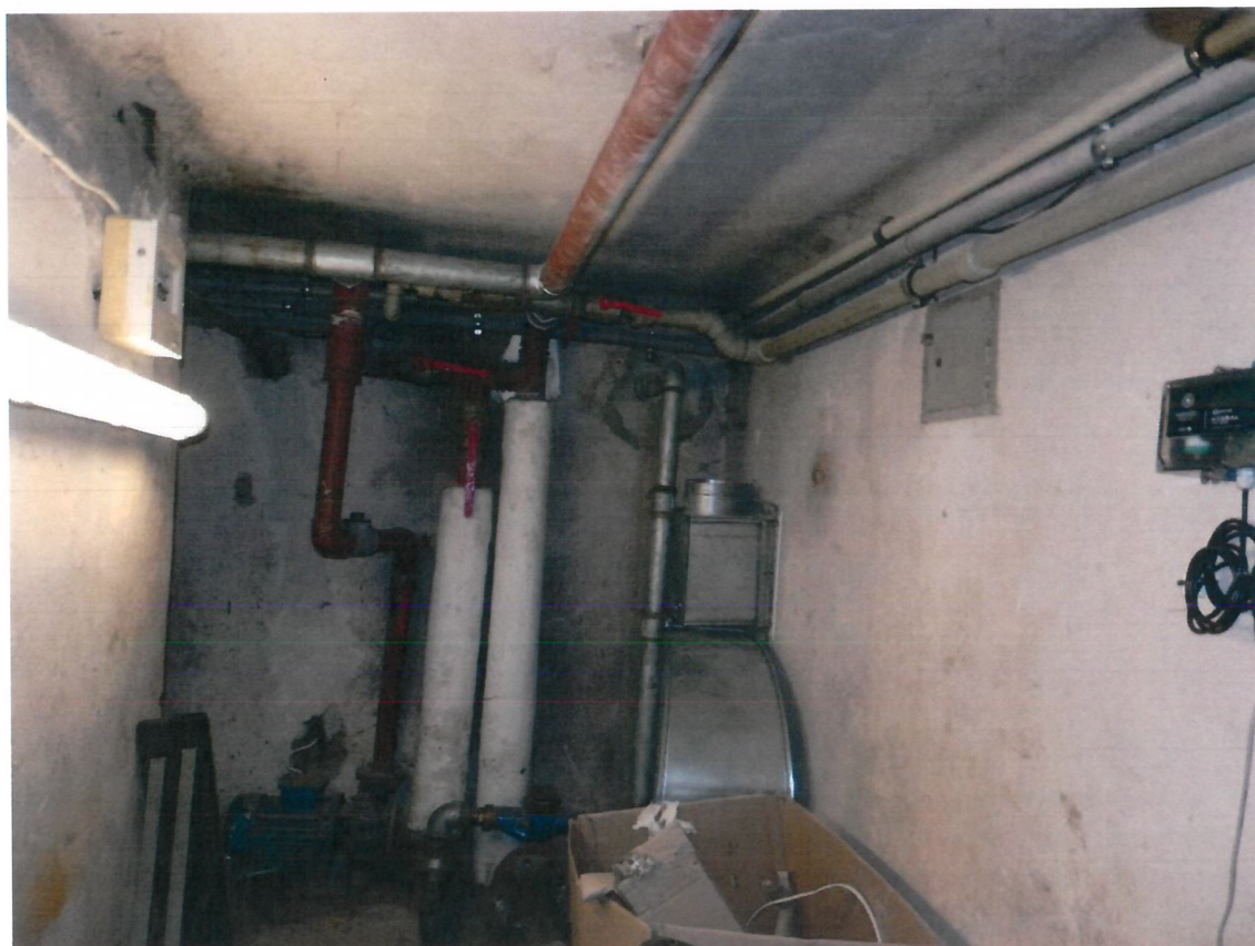
Fot.[29] Przyłącza wodociągowe – stan średni.
