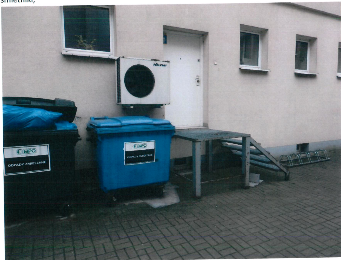
Fot.[32] Śmietniki zewnętrzne na terenie niezadaszonym – stan średni.
