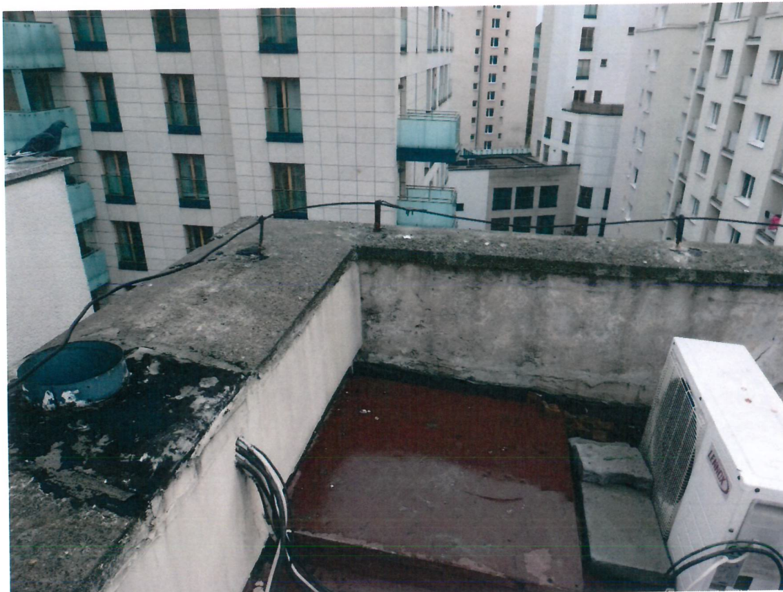
Fot.[6] Nakrywy betonowe ogniomurków – stan dostateczny.
