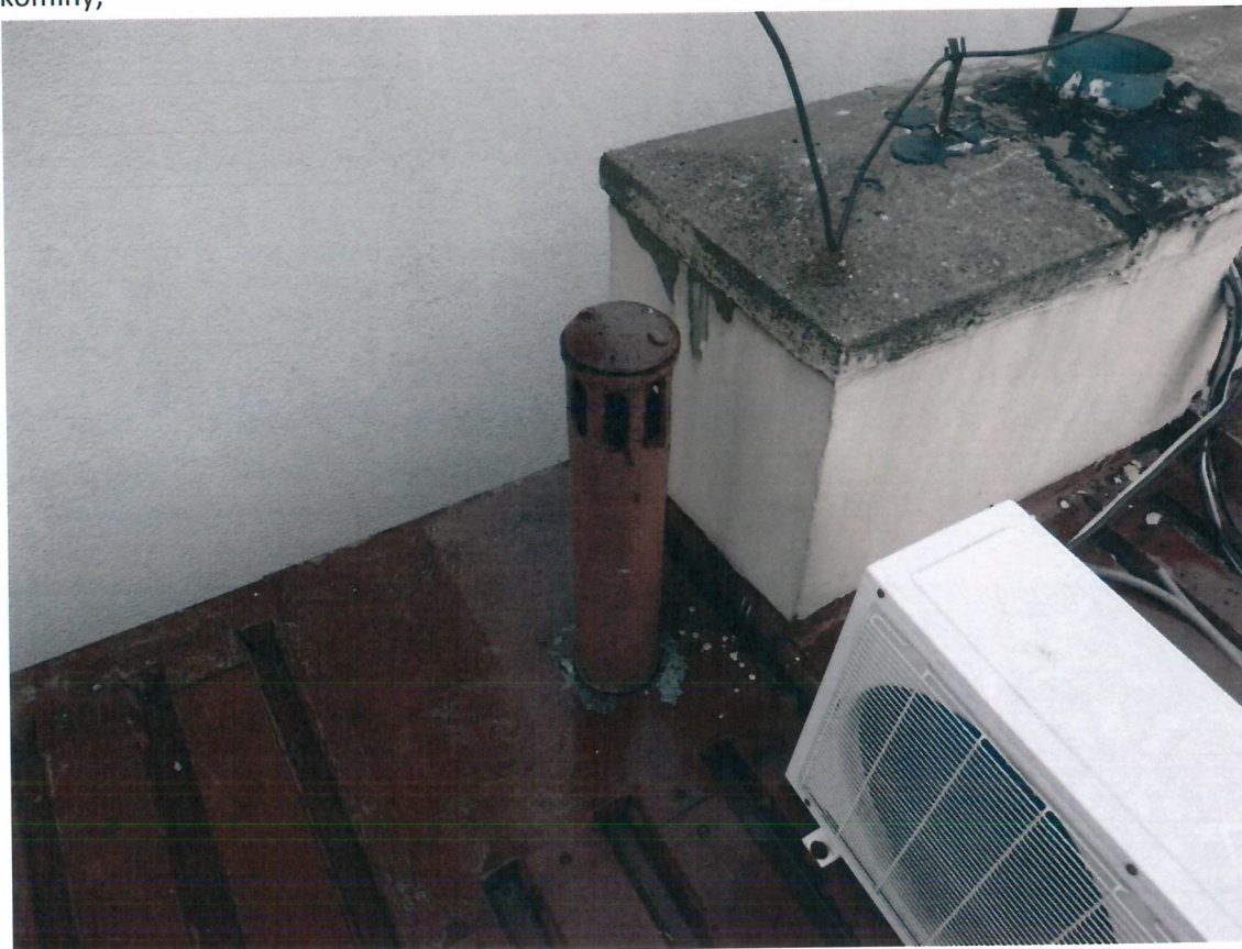
Fot.[4] Kominki wentylacji grawitacyjnej – stan średni.
