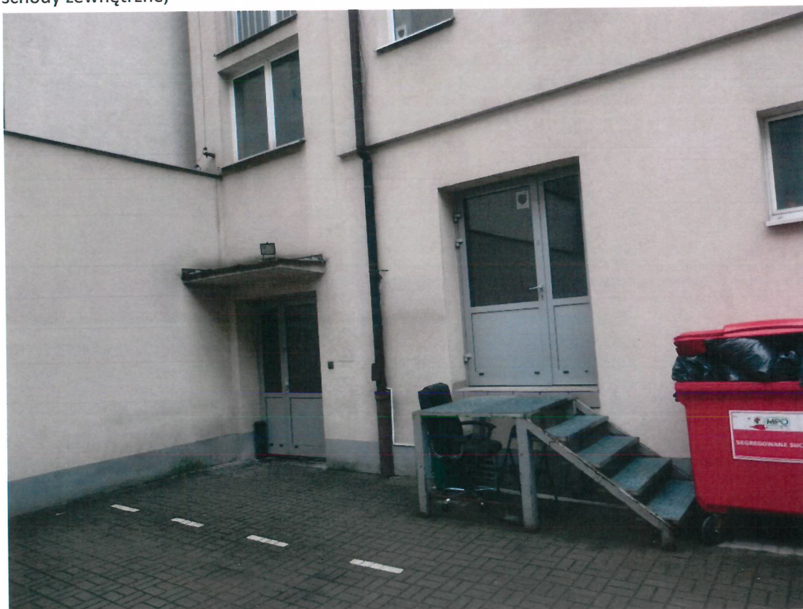
Fot.[36] Stalowe schody zewnętrzne – stan średni.
