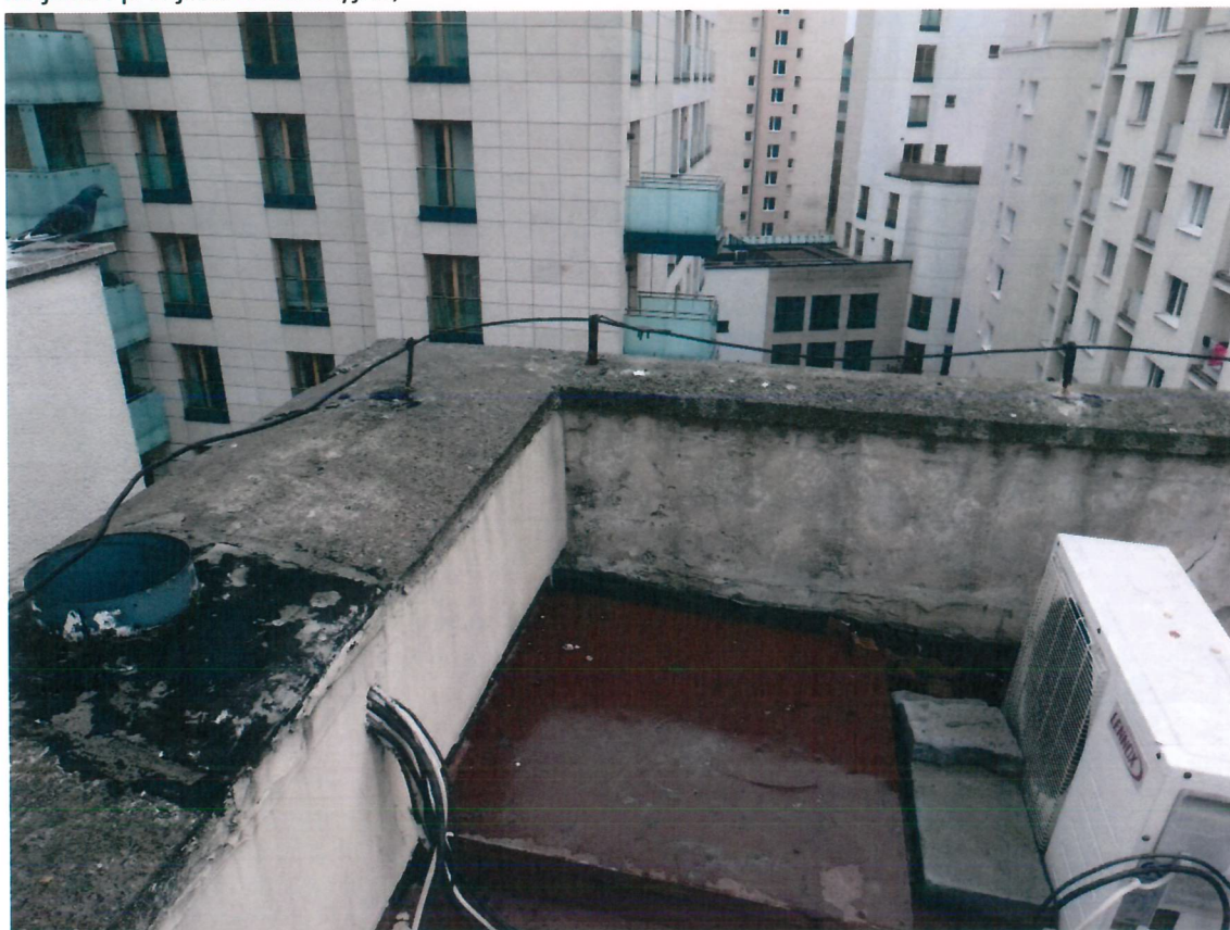
Fot.[28] Przejścia instalacyjne na dachu – stan dopuszczający.
