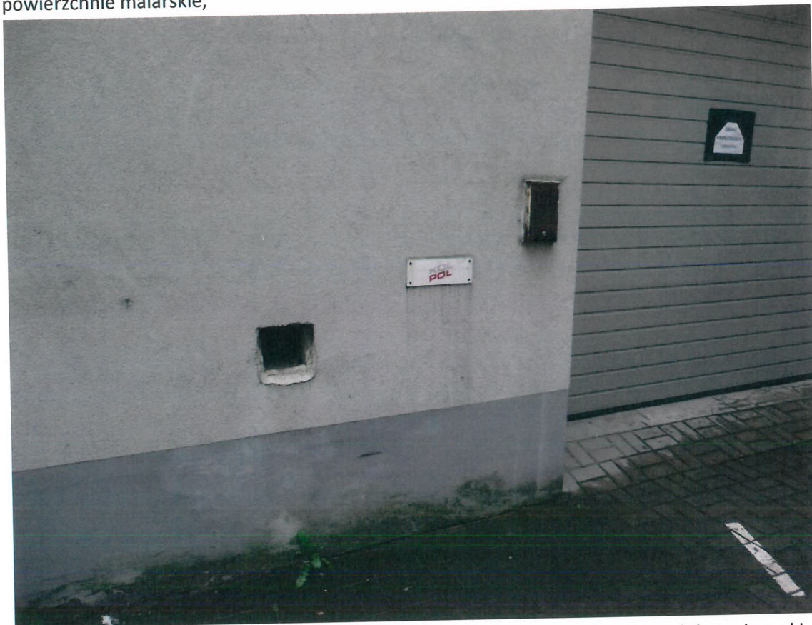
Fot.[21] Powierzchnie malarskie: elewacji - stan dostateczny, wnętrza –stan dobry, skrzynki, osłony itp. - stan zły.
