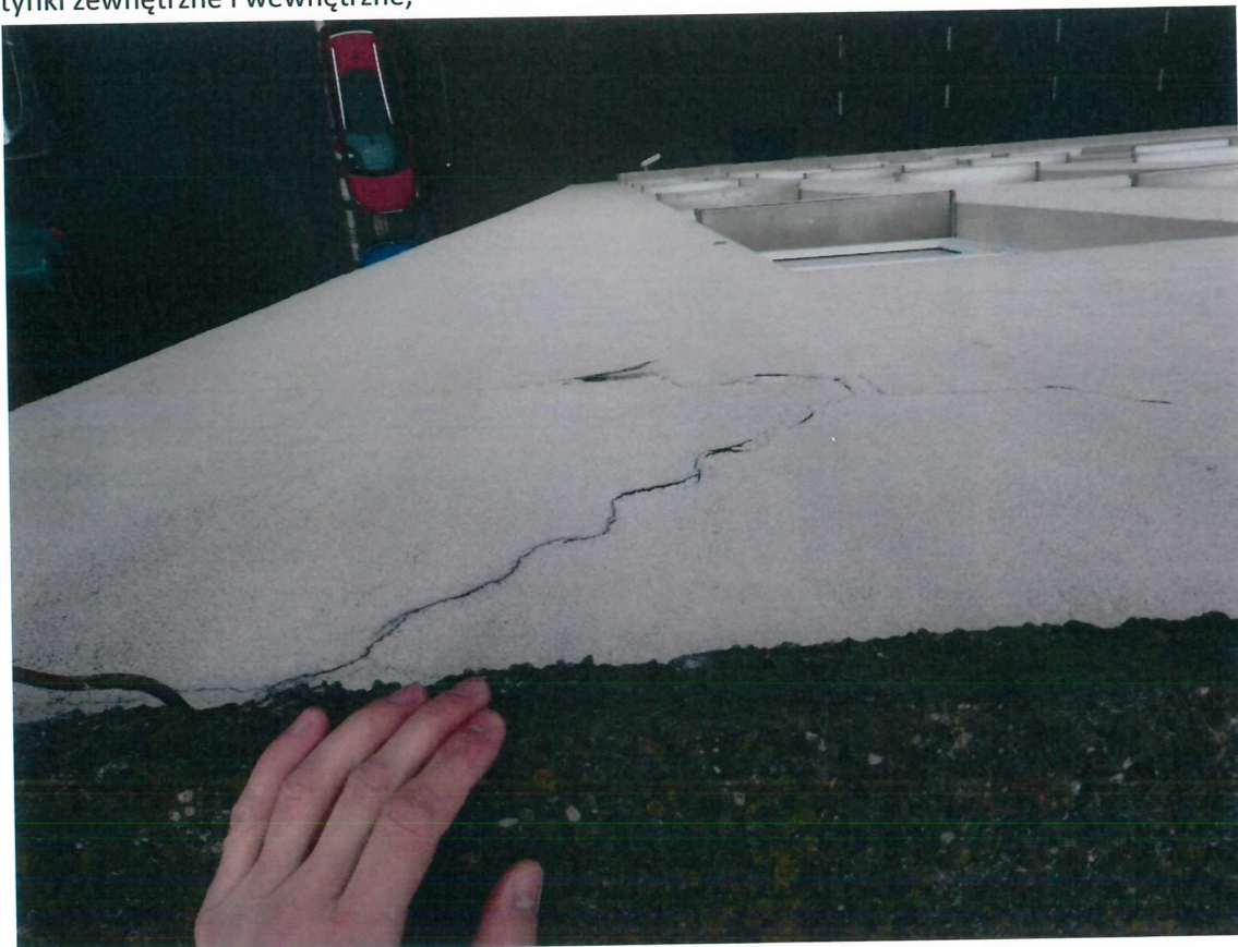
Fot.[16] Tynki zewnętrzne - stan dostateczny, miejscami dopuszczający.
