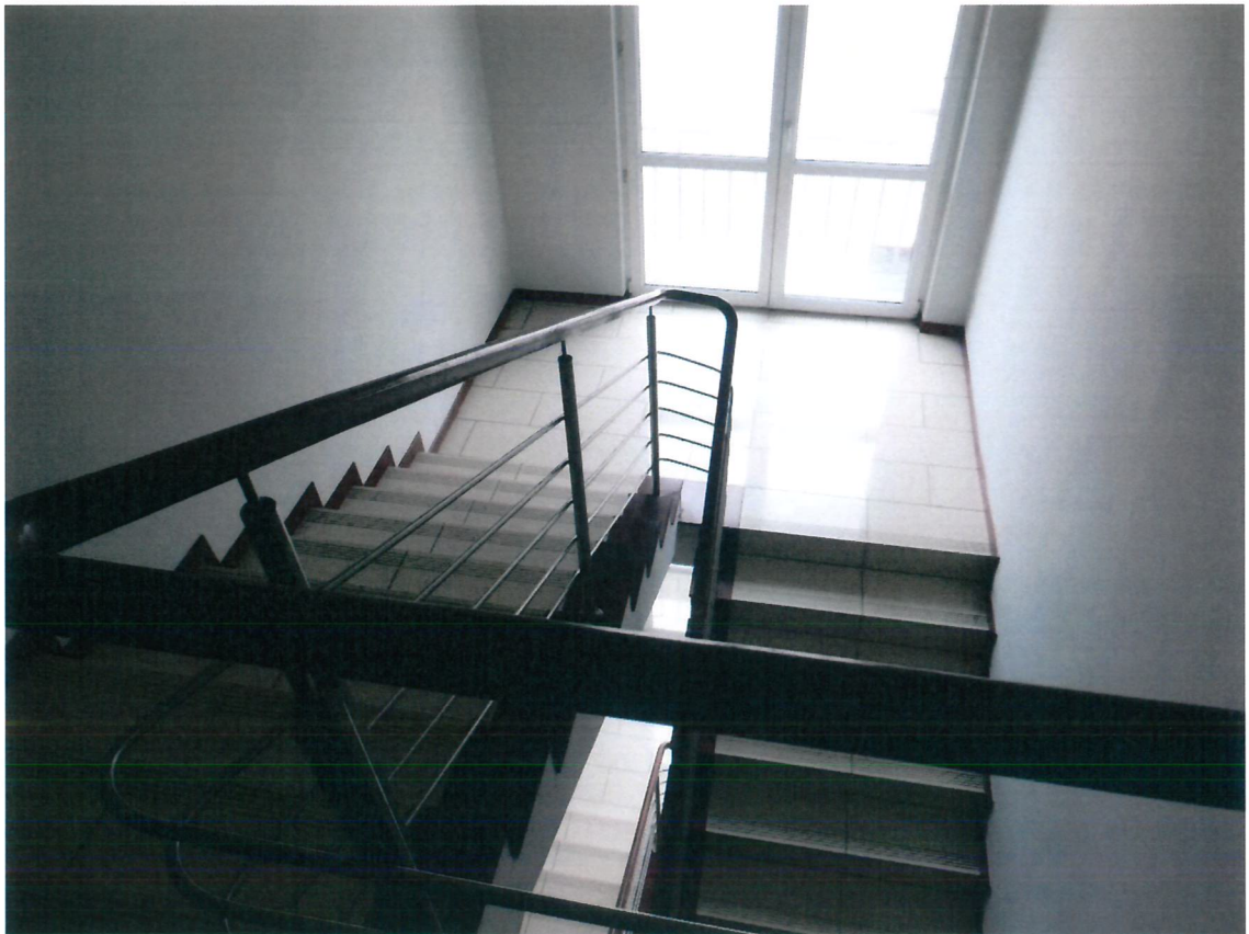
Fot.[20] Klatki schodowe, schody, posadzki klatek i balustrady – stan dobry.
