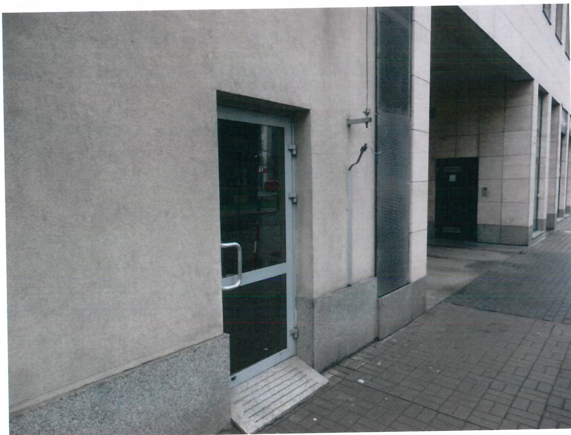
Fot.[17] Tynki zewnętrzne i elewacja - stan dostateczny.
