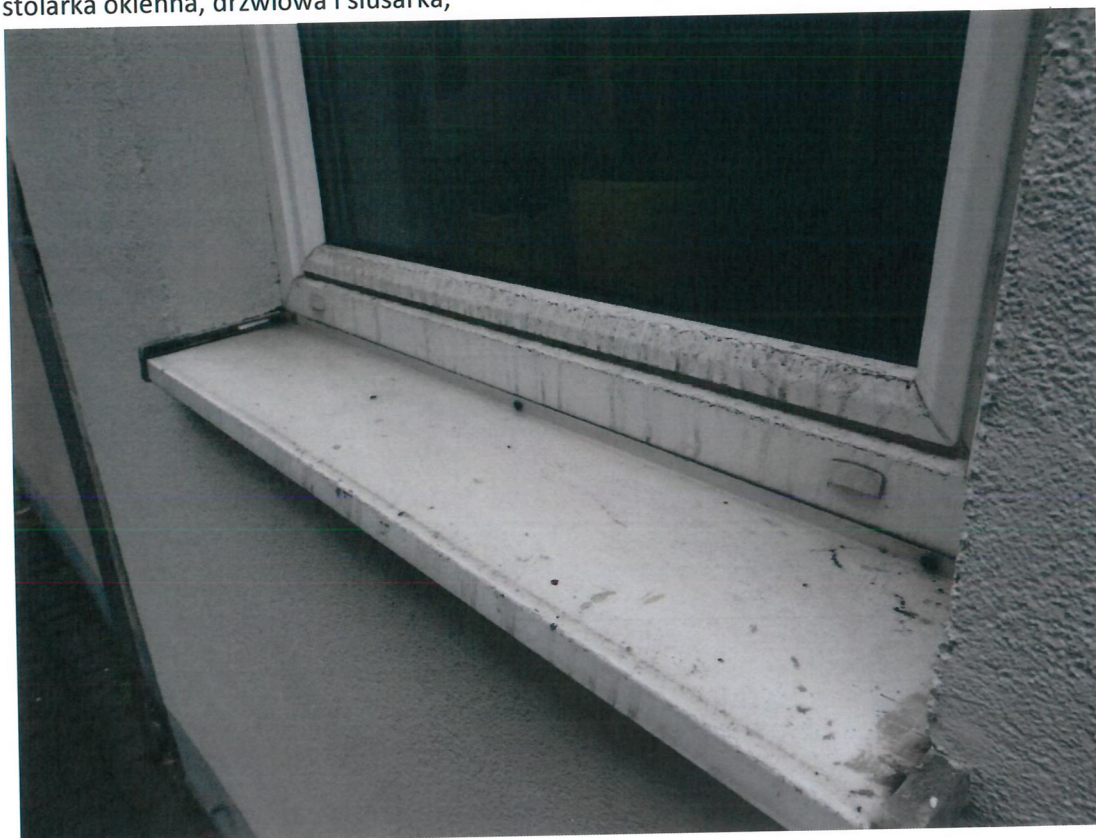
Fot.[22] Parapet zewnętrzny – nieprawidłowo zamontowany – stan dopuszczający.
