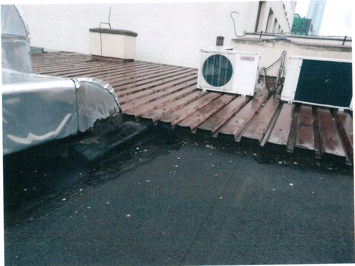
Fot.[2] Pokrycie dachowe wyższej części budynku - papa termozgrzewalna – stan średni.
