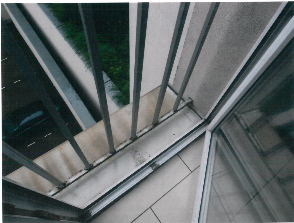
Fot.[15] Balustrady klatek schodowych – stan średni.
