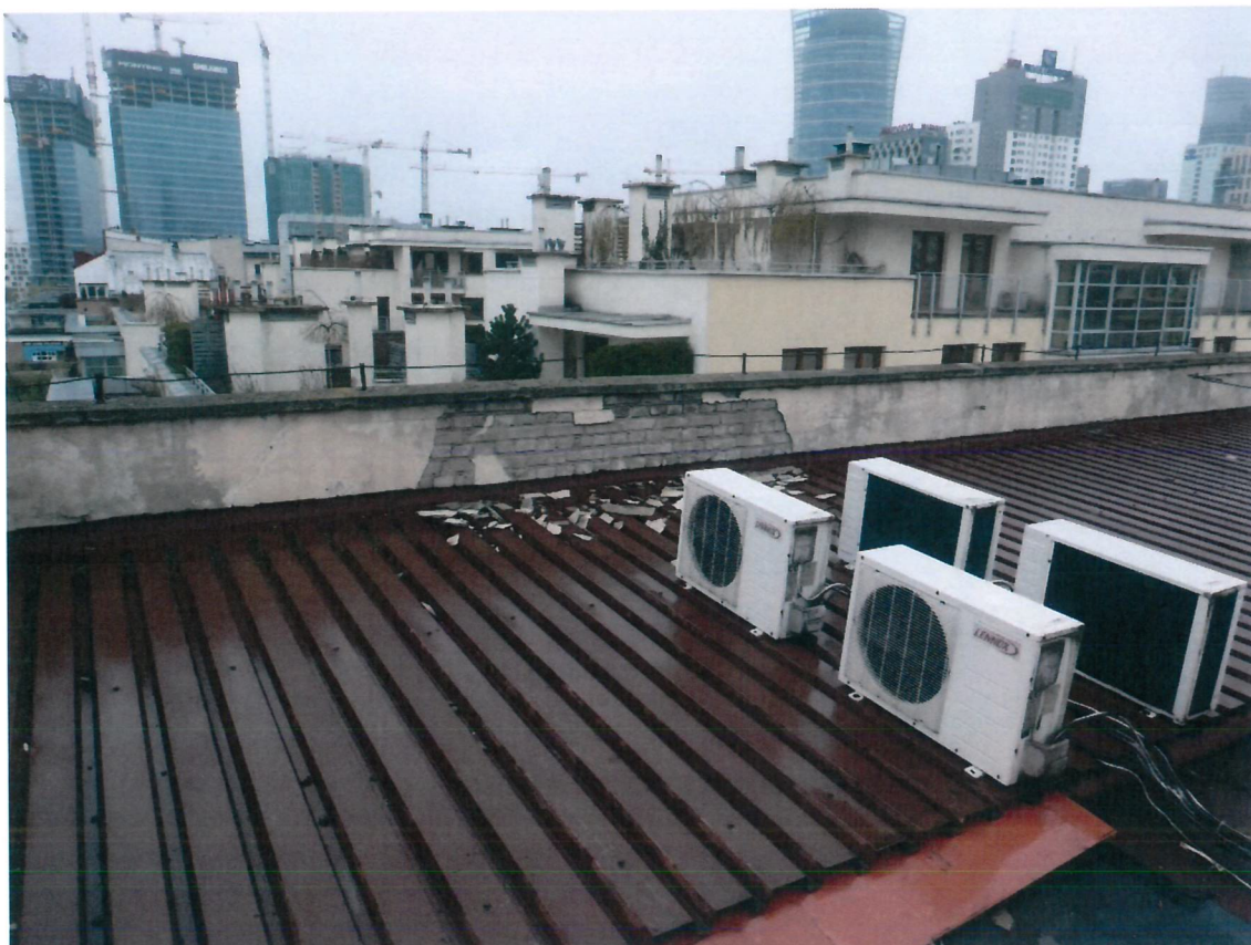
Fot.[14] Tynki ogniomurków – stan zły.
