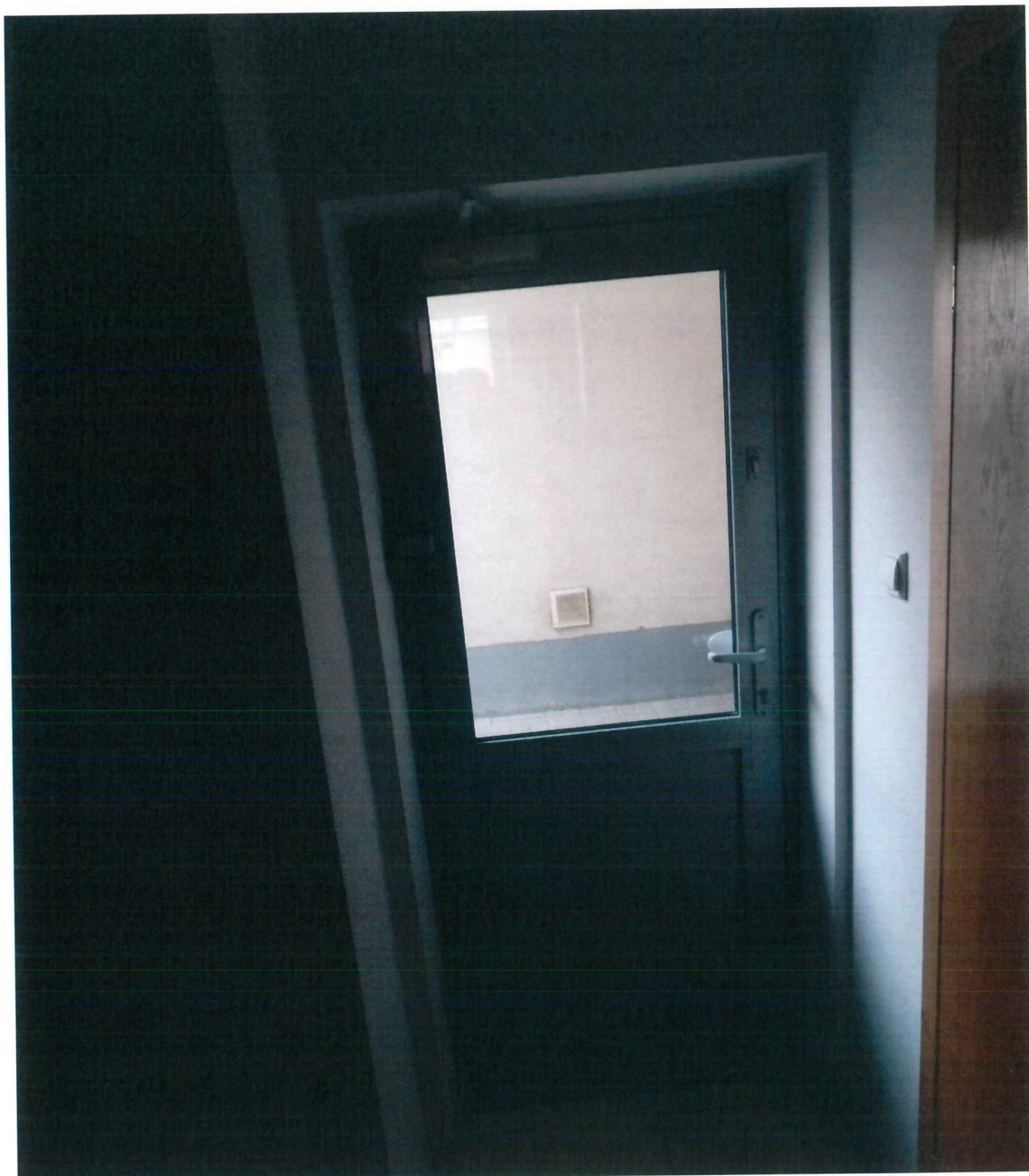
Fot.[23] Drzwi zewnętrzne – stan średni.
