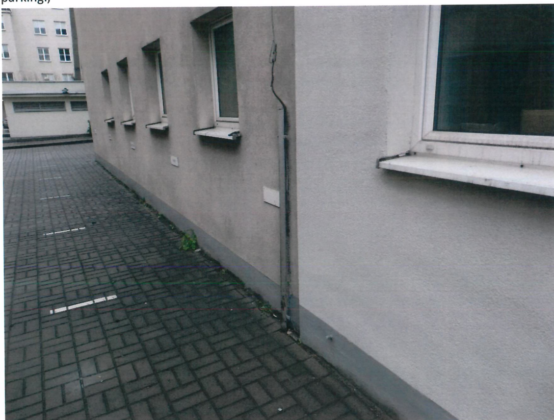
Fot.[34] Nawierzchnie parkingów zewnętrznych – stan średni.
