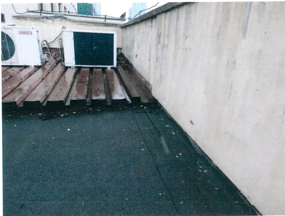
Fot.[1] Pokrycie dachowe wyższej części budynku - blacha trapezowa – stan dostateczny.
