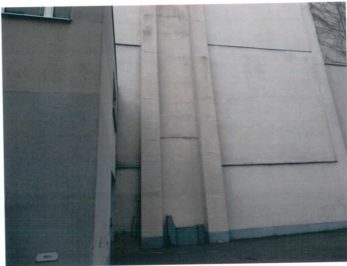
Fot.[18] Elewacja budynku sąsiedniego - stan dopuszczający.
