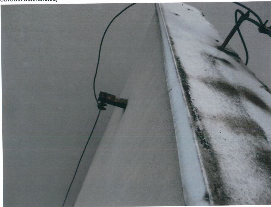
Fot.[5] Obróbki blacharskie ogniomurków – stan dostateczny.
