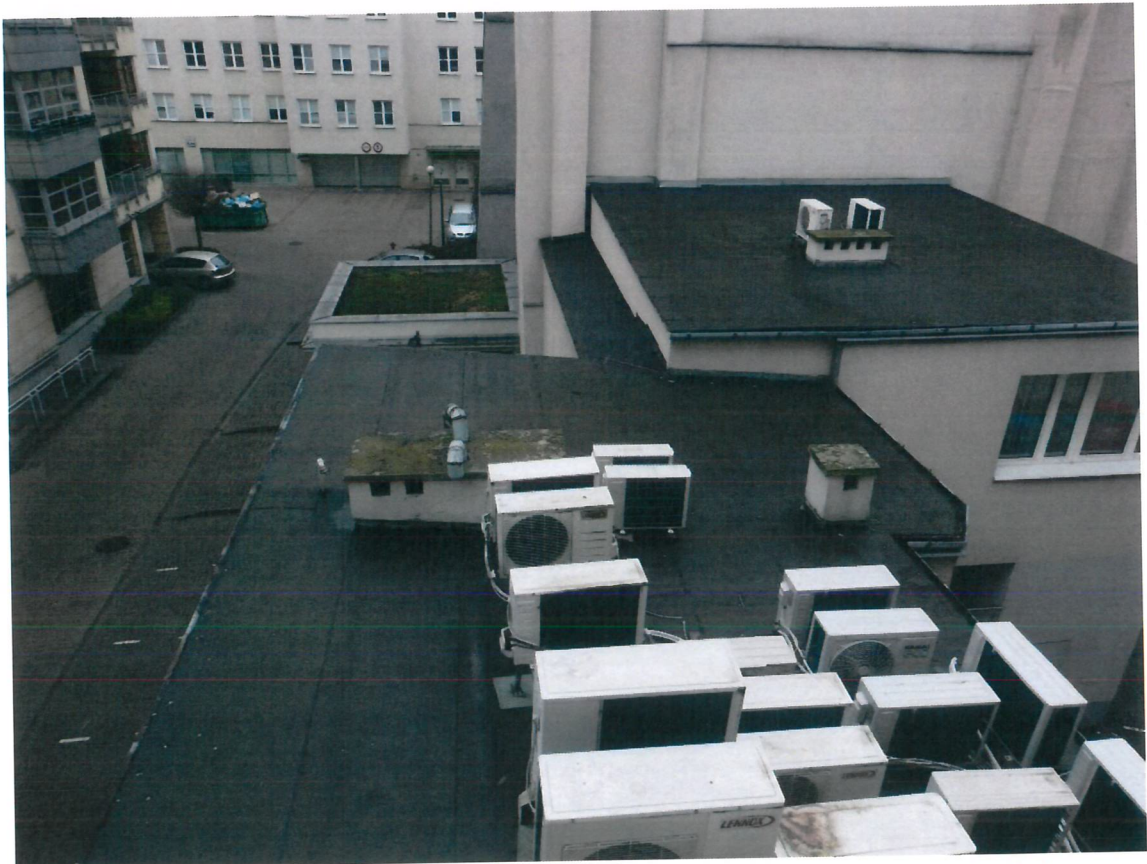
Fot.[3] Pokrycie dachowe niższej części budynku - papa termozgrzewalna – stan średni.
